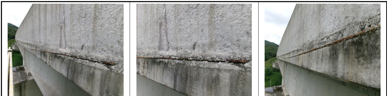
① 바닥판하면 철근노출 - 진전 여부확인
